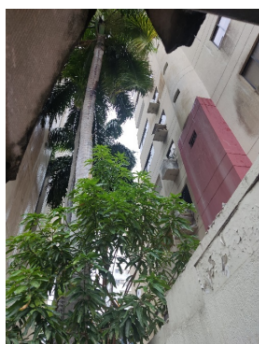
Imagen 1: Ramas extendidas a edificio vecino
