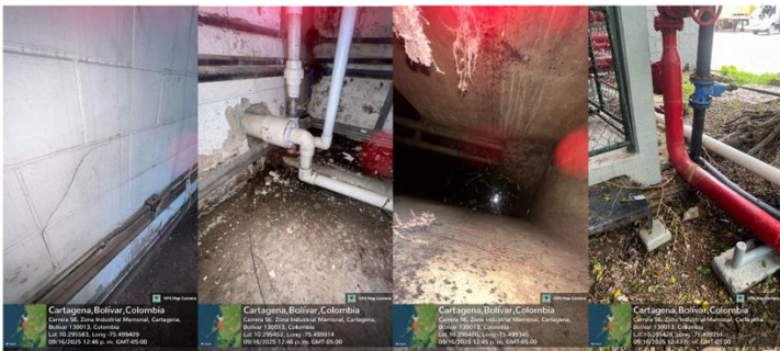
Imagen 2: Ficus benghalensis (Caucho): Afectación estructural en el cuarto de máquina – afectación al desagüe – afectación por sistema radicular a la red contra incendio. Fuente: Técnico Contratista
