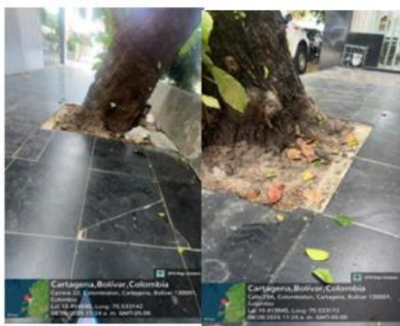
Imagen 1: Afectación estructural en la terraza del predio. Fuente: Técnico Contratista
