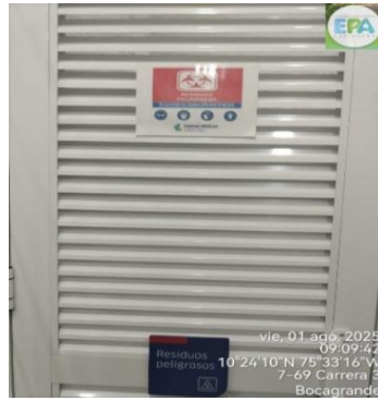
Foto 4. Puerta rotulada de Almacenamiento interno RESPEL
