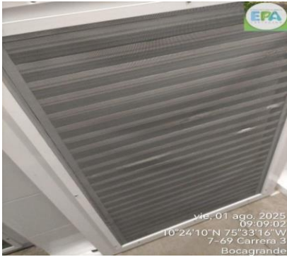
Foto 10. Malla metálica para evitar ingreso de vectores
