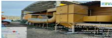
Figura. Sistema De Control De Emisiones Cuarto Pintura
