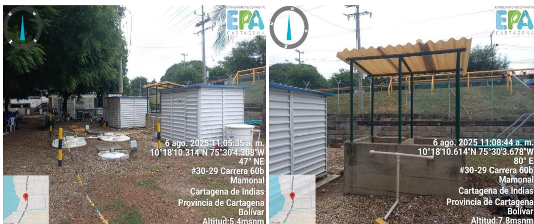
Figuras 6 y 7. PTARD y lechos de secado de lodos
