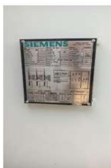
Figura 15. Tabla de información del transformador
