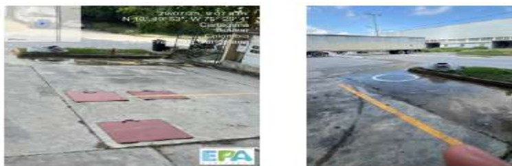
Figura 3. Desborde de agua potable en su sistema de almacenamiento.
