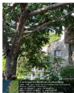
Imagen 6: Spondias mombin (Jobo) ramas en contacto con cableados eléctricos Fuente: Técnico Contratista
