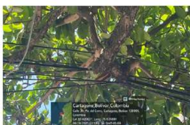
Imagen 3: Ramificaciones de Terminalia catappa (almendro) en contacto con cableado eléctrico Fuente: Técnico Contratista
