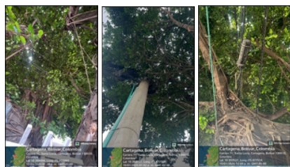
Imagen 3: Ramificaciones entrelazadas con cableado eléctrico y redes telefónicas Fuente: Técnico Contratista
