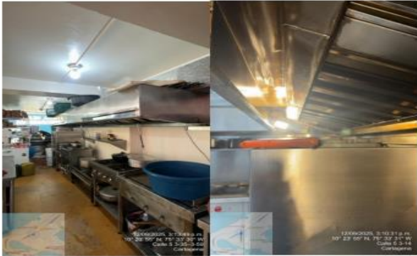
Figura 4: Campana extractora Fuente: Propia
