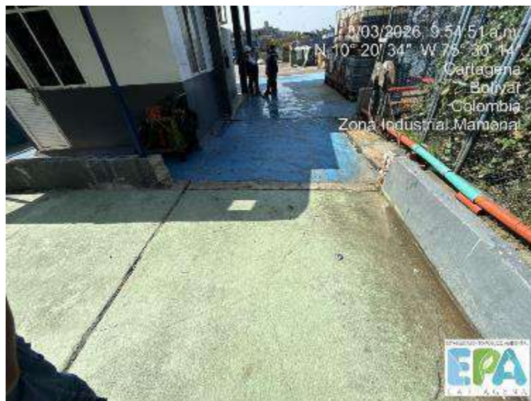
Ilustración 5. Área sin muro de contención adecuado.
