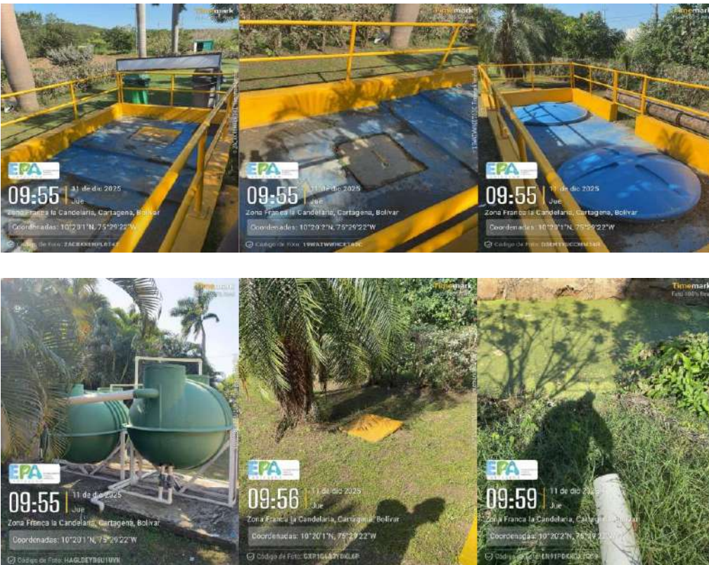
Figura 3. PTAR - KNAUF DE COLOMBIA S.A.S. Fuente: EPA CARTAGENA, 2025.
