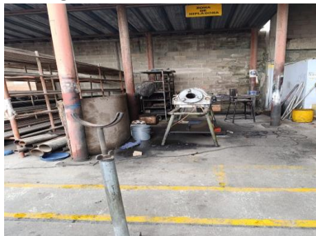
Fugas de aceite en el suelo zona nipladora
