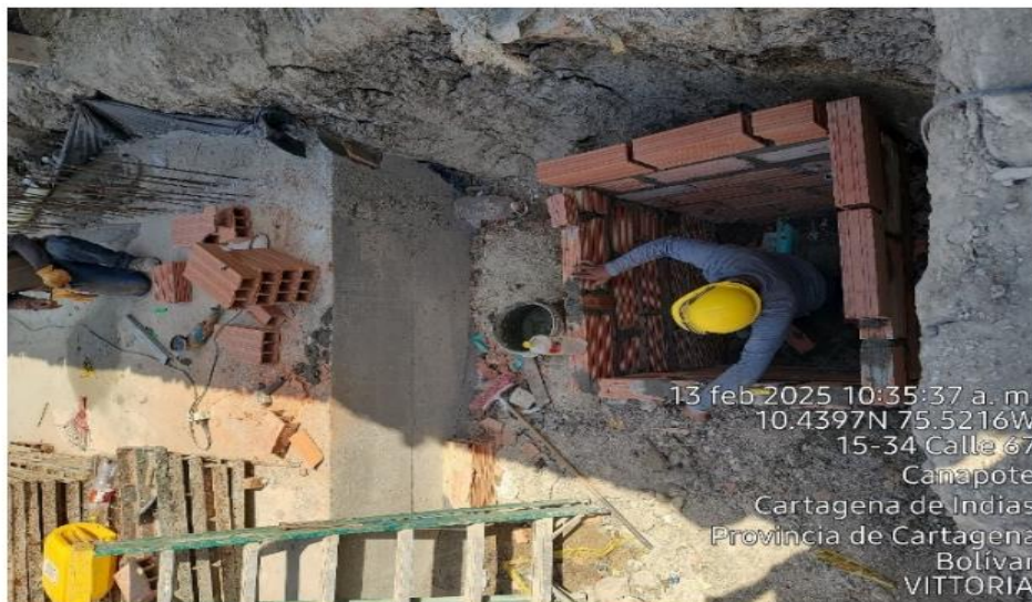
Ilustración 7. Construcción del sistema de almacenamiento de las aguas provenientes del lavado de Mixer
