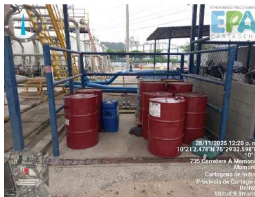
Figura 33. Centro de acopio para aceites usados
