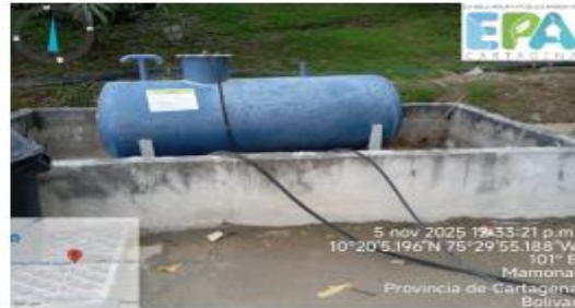
Figura 5. Tanque almacenamiento ACPM
