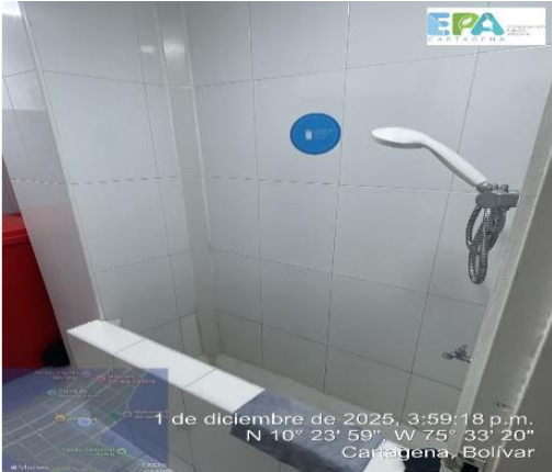
Foto 5. Acometida de agua.
