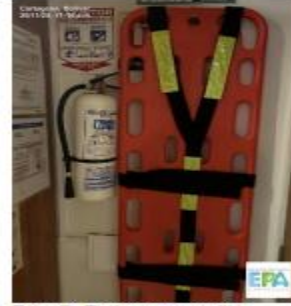
Foto 7. Extintor y camilla
