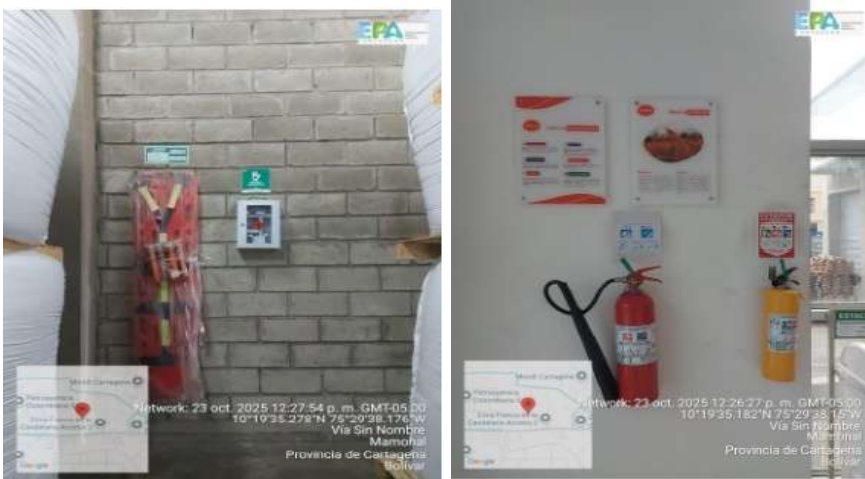
Figura 10. Equipos para atender emergencia y contingencia.
