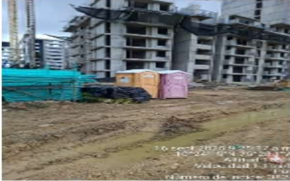
Ilustración 7. unidades sanitarias portátiles ubicados en obra.
