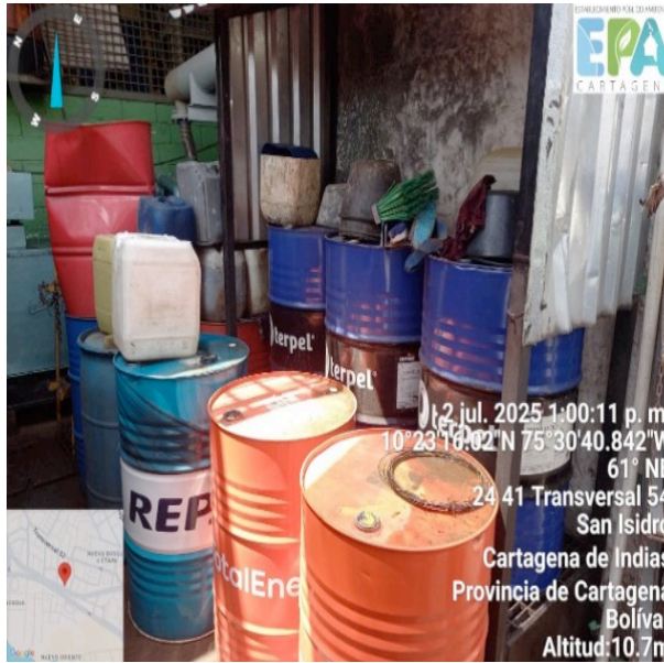
Figura 3. Tanques para almacenar aguas aceitosas
