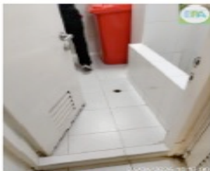
foto 6. Rejilla y dique de contención
