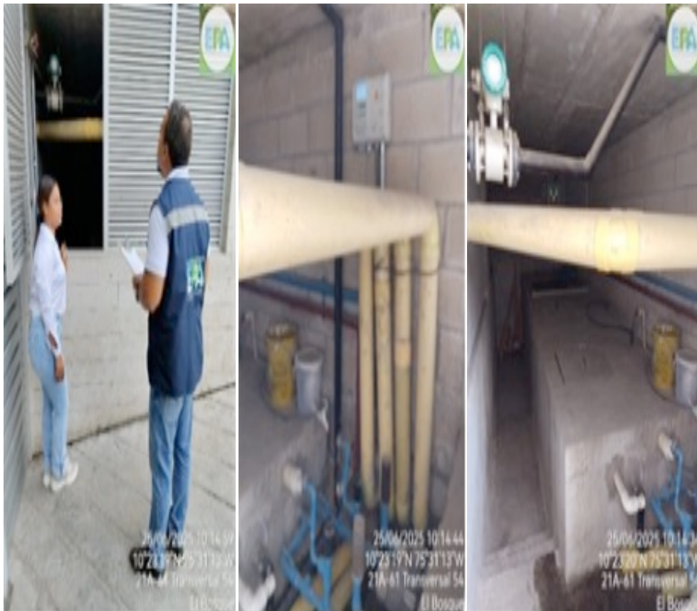
foto 12. Planta de tratamiento de agua residual (PTAR).
