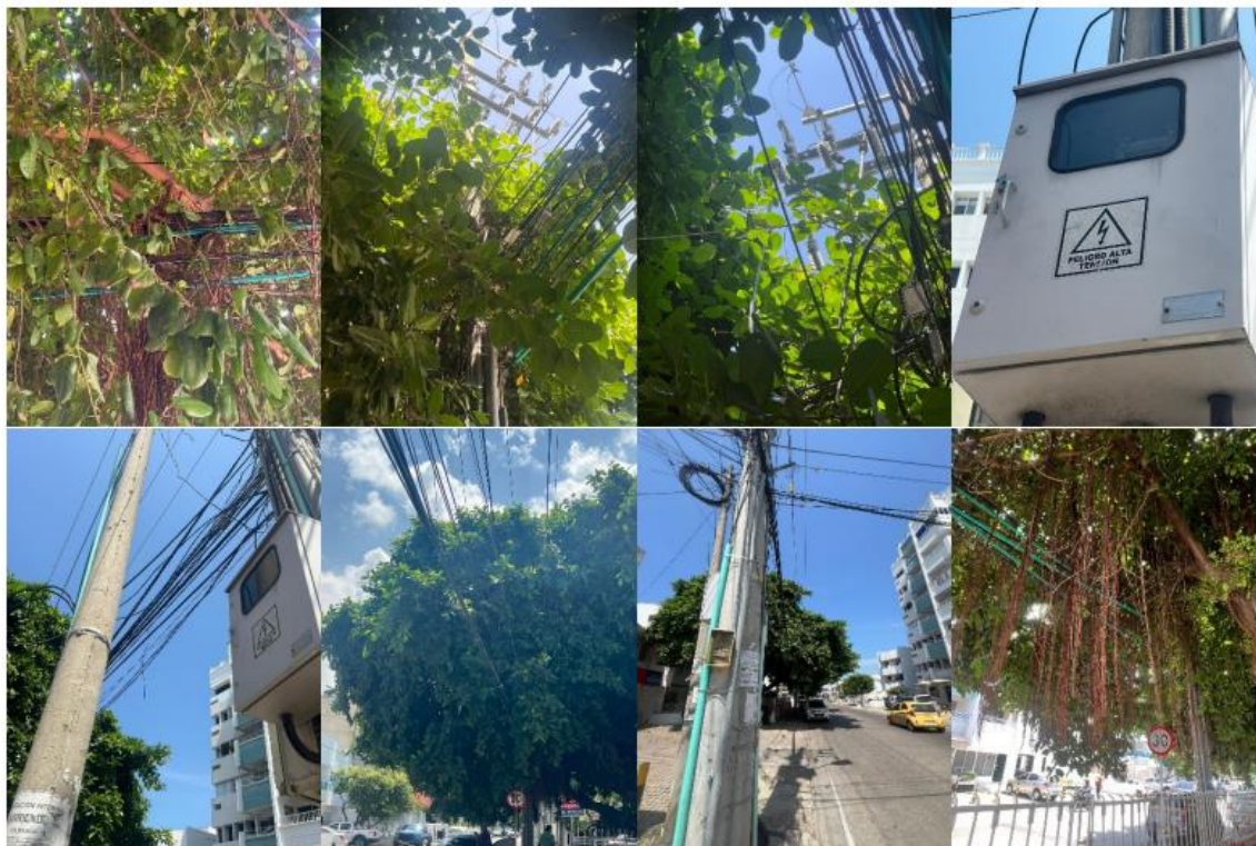
Imagen 2: Individuo arbóreo con ramificaciones entrelazadas con cableado de media y alta tensión Fuente: Técnico Contratista
