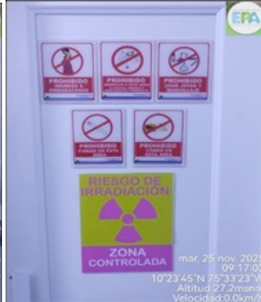
Foto 6. Cuarto de decaimiento de residuos radiactivos
