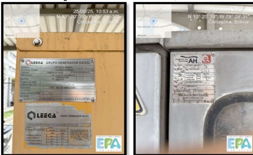
Figura 22. PLACA INFORMATIVA DE LOS EQUIPOS
