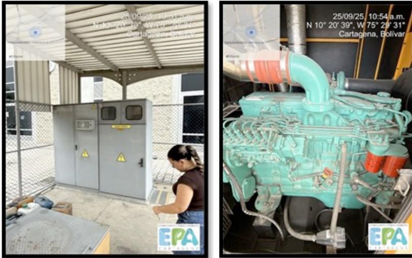
Figura 21. PLANTA ELECTRICA Y EQUIPO
