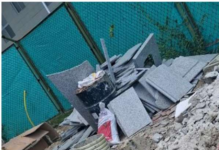
Ilustración 7. Almacenamiento de residuos de tipo pétreo sin la respectiva delimitación y señalización.
