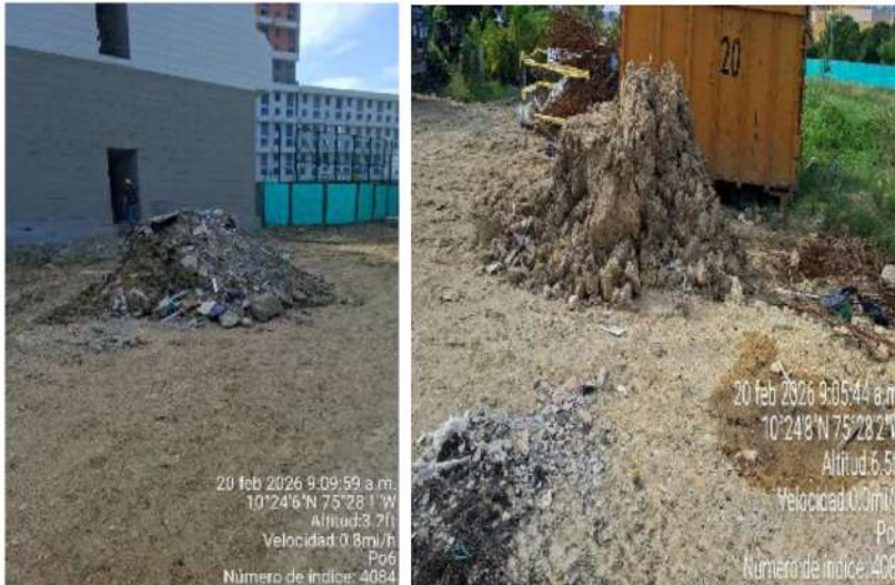
Ilustración 5. Área de almacenamiento de RCD producto de los cortes, limpieza de terreno sin señalización y mezclados.
