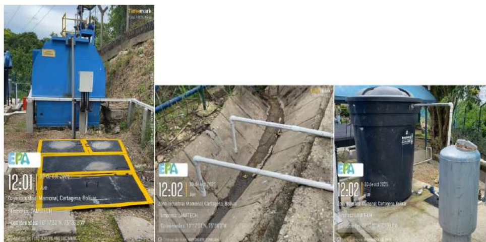
Figura 3. Sistema de tratamiento y punto de vertimiento ARD
