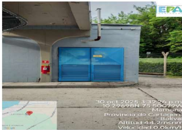
Figura. Planta Eléctrica.
