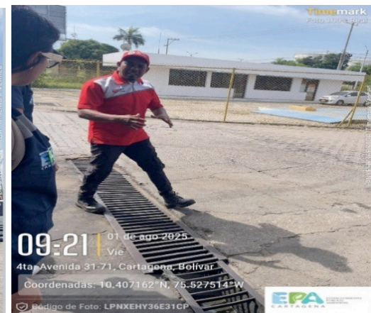
Figura 7 canaletas conducidas a la trampa de grasa
