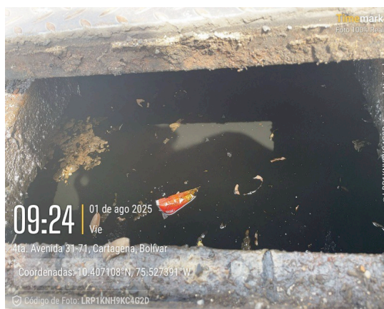
Figura 13. Aguas hidrocarbonadas contenidas en la trampa de grasa
