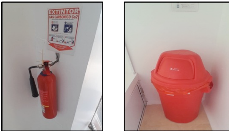
Foto 10 (recipiente de RESPEL Rotulado), 11 (extintor contra incendio)..
