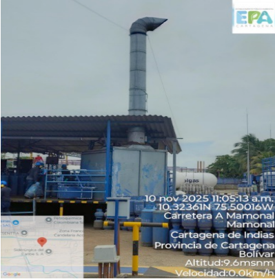
Figura 20. Cabina de pintura
