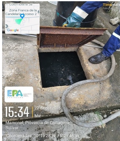
Figura 10. Tanque almacenamiento ARD.
