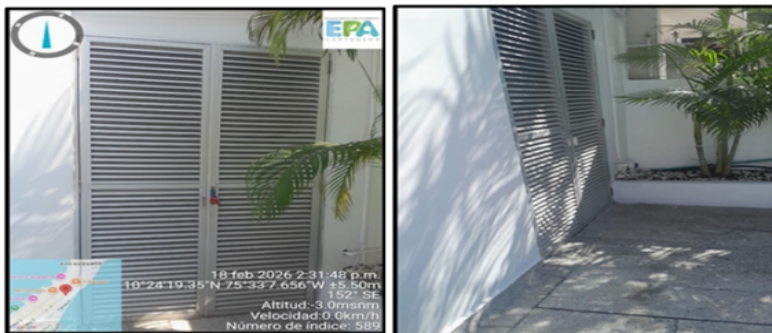
Foto 7 y 8. Almacenamiento de RESPEL (Puertas Sin Rotulado y sin extintor)
