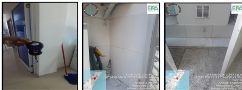
Foto 9 uso de (bascula), 10 (paredes adecuadas) y 11 (sin muro de contención).
