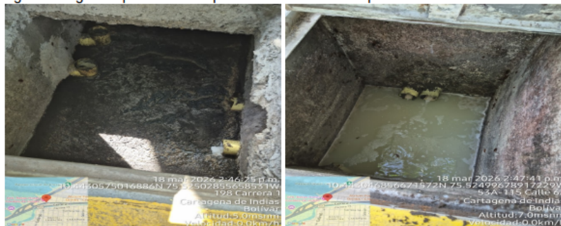
Figura 2: Trampa de Grasas Fuente: Propia
