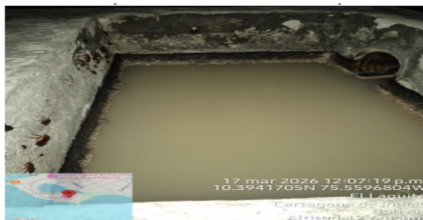
Figura 2: Trampa de Grasas Fuente: Propia
