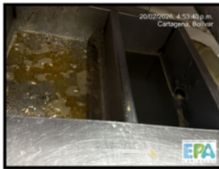
Ilustración 3. Estado de Trampa de Grasas.
