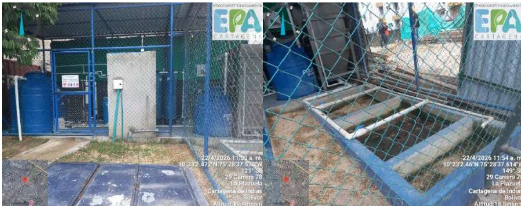
Figuras 22 y 23. PTAR
