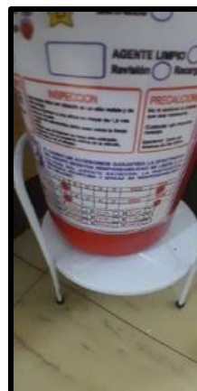
Foto 11 (extintor contra incendio vigente)
