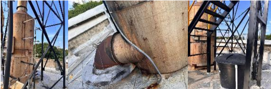
Foto 12-14. Sistema de control de emisiones lavador de gases y postcombustión
