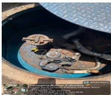
Figura 3. Tanque subterráneo Extra.
