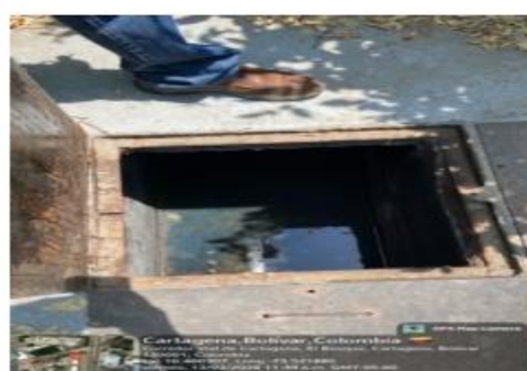
Figura 10. Ultima trampa de grasa.
