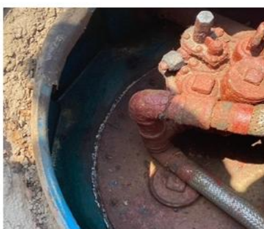
Figura 6. Tanque subterráneo Corriente.
