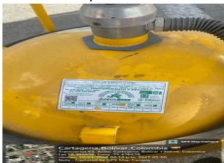
Figura 13. Extintor satelital Vigente
