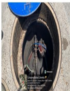
Figura 3. Tanque subterráneo Extra.
