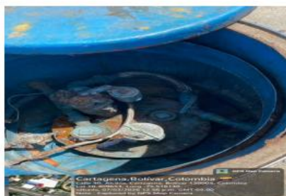
Figura 3. Tanque subterráneo Extra.
