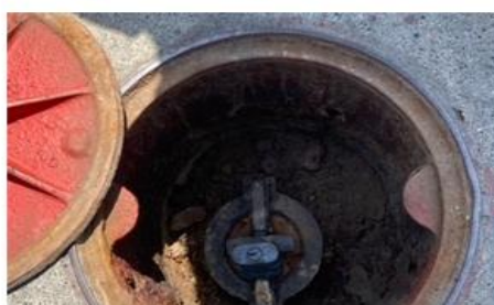
Figura 4. Bocatoma llenado corriente.
