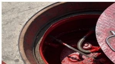
Figura 6. Tanque subterraneo Corriente.
