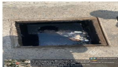
Figura 8. ULTIMA TRAMPA DE GRASA
