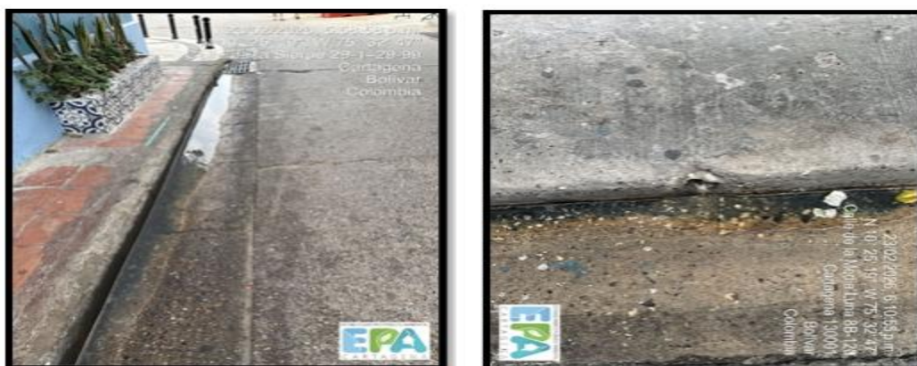
Ilustración 3. Vertimiento de aguas residuales
