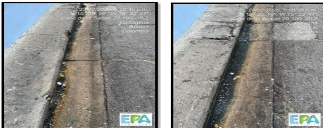
Ilustración 2. Vertimiento de aguas residuales
