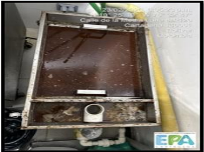
Ilustración 7. Estado de Trampa de Grasas.
