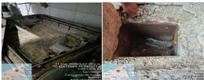
Figura 2: Trampa de Grasas Fuente: Propia
