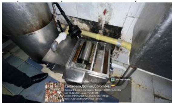
Figura 2: Trampa de Grasas Fuente: Propia
