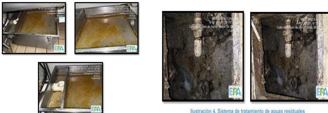
Ilustración 4. Sistema de tratamiento de aguas residuales
